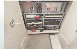
配电箱 Electric Box
